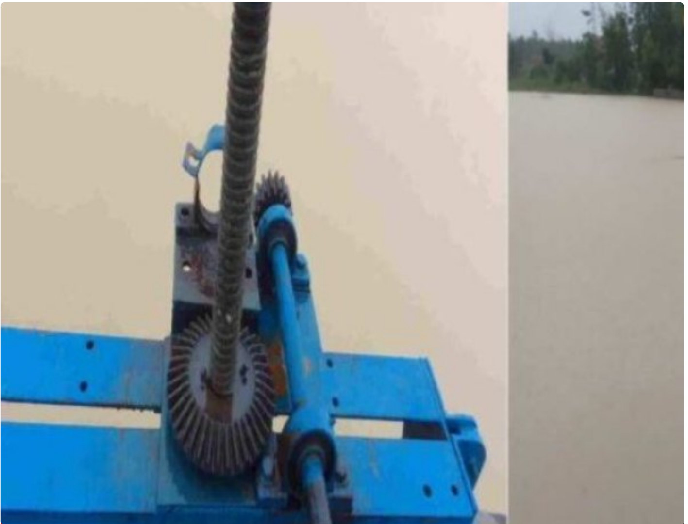
Pintu air Albaret Simpang Mesuji
